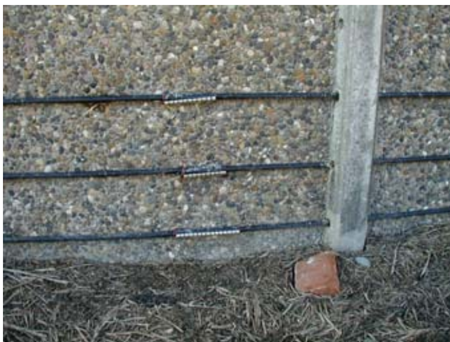
Figur 7.8 Her er huller i tre kabler udbedret af kontrollanten.
