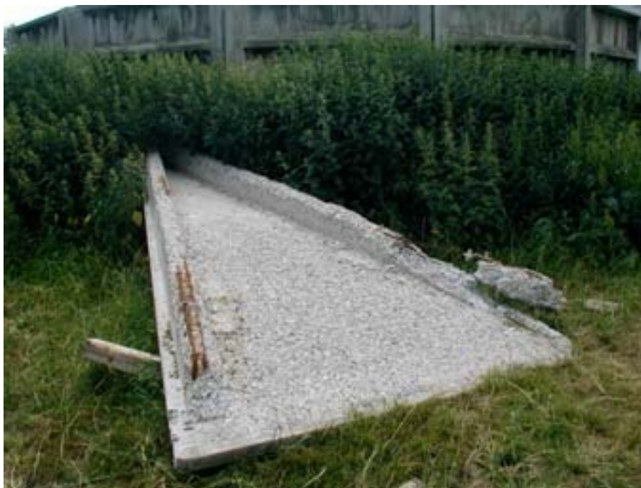
Figur 7.17 Beholderlåg (undersiden) fra gødningsbeholdere. Det er kraftigt eroderet som følge af manglende ventilation og en beholdervæske, der tilsættes industriaffald.
