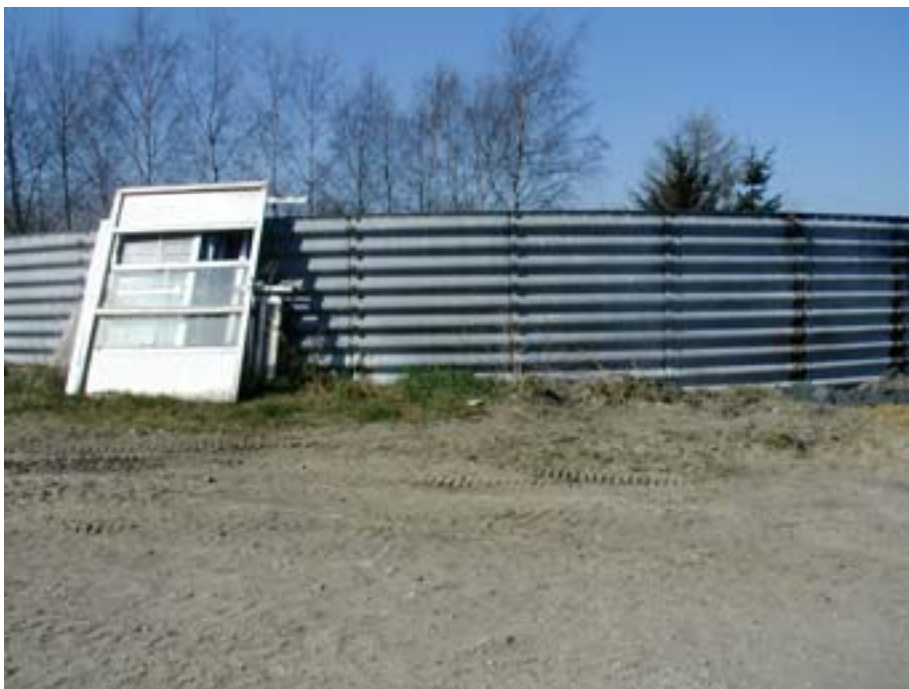
Figur 5.2 Stålbeholder med væg af bølgeprofiler. Beholderen har fundament under terrænniveau.
