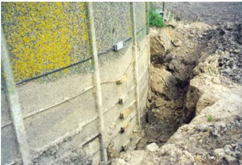
Figur 7.3 Ved denne beholder er alle samlinger i kabler samlet over hinanden. Normalt vil de sidde spredt og der er ikke sikkert, at der er samling der hvor der graves op. Det ses, at et kabel er sprunget.
