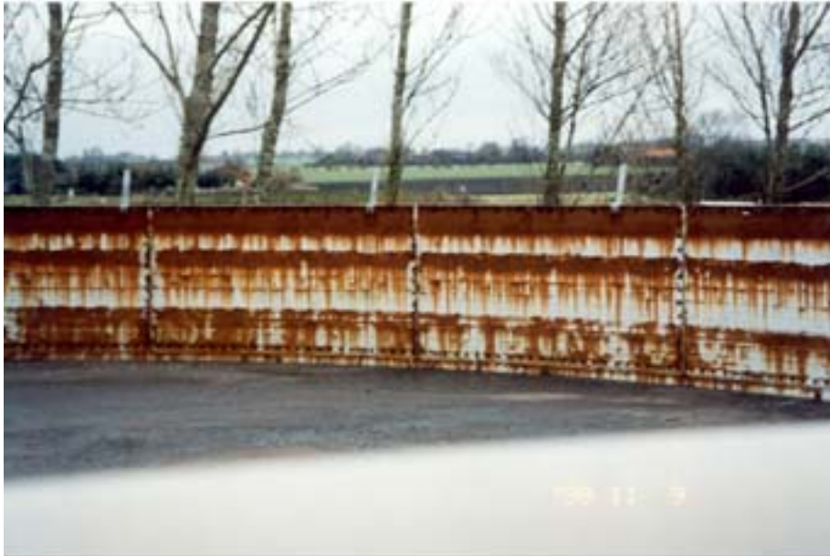
Figur 5.7 Overfladebeskyttelsen på indersiden af denne beholder er stort set forsvundet og pladerne ruster.
