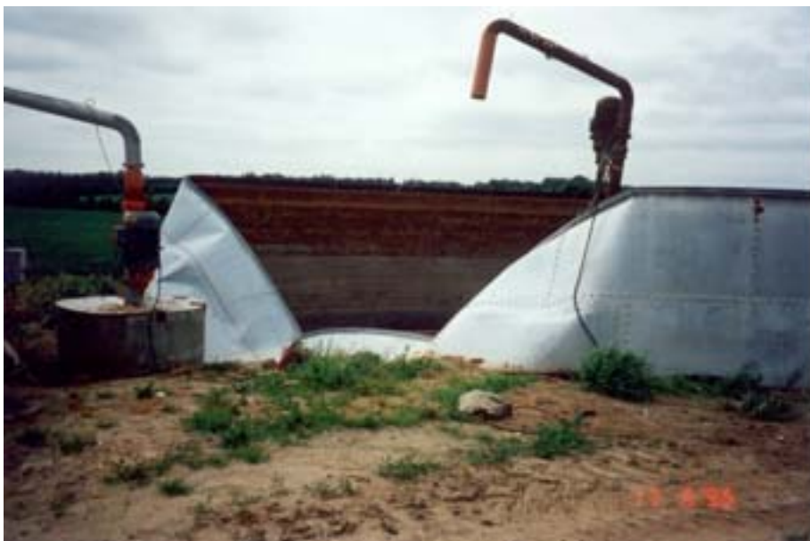
Figur 5.8 Denne delvis nedgravede stålbeholder har været udsat for ensidigt vandtryk i tom tilstand. Det kan den ikke klare.
