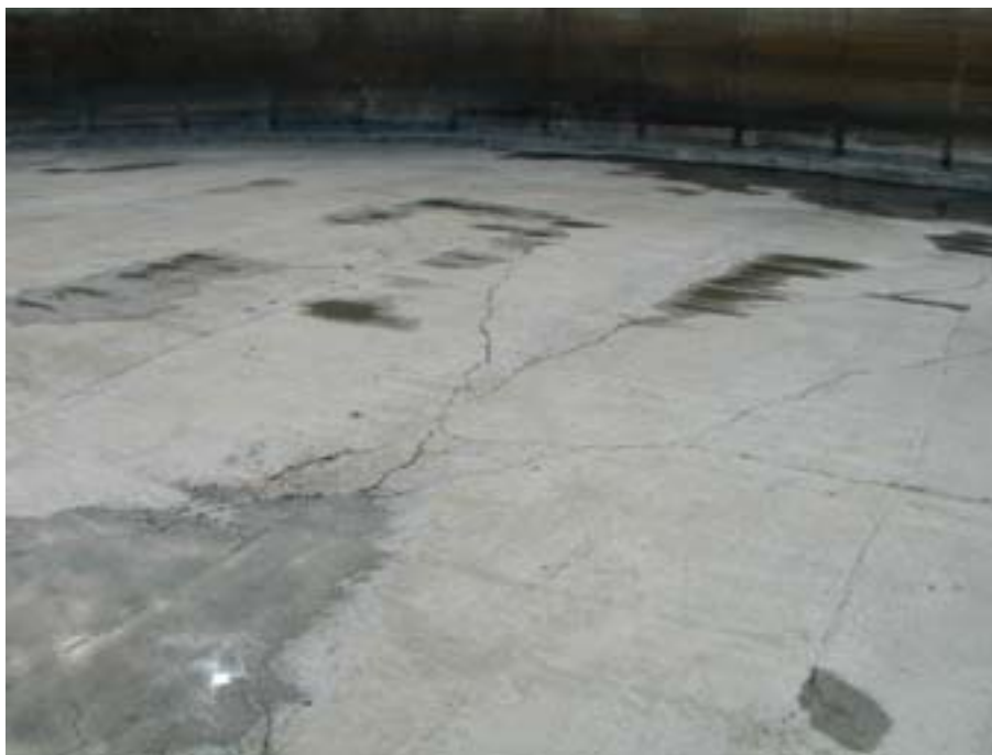
Figur 7.15 Rengjort bund i beholder. Bunden er revnet som følge af opskudt bund (fra udvendigt vandtryk). Beholderen er utæt, hvilket kunne konstateres som følge af udsivende gylle. Normalt kontrolleres bundplader ikke, da der ikke kræves tom beholder ved kontrollen.
