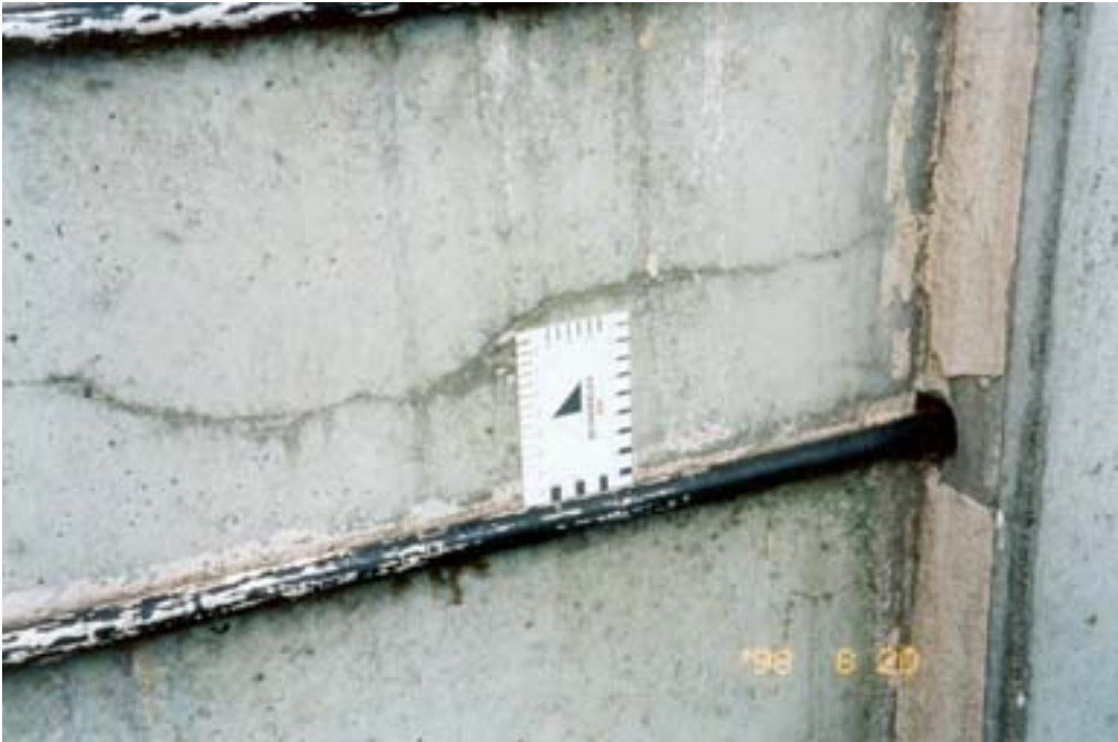
Figur 7.11 Revner ser ofte i beholdere af beton. Små revner uden gennemsvivning af gylle som her er uden betydning.
