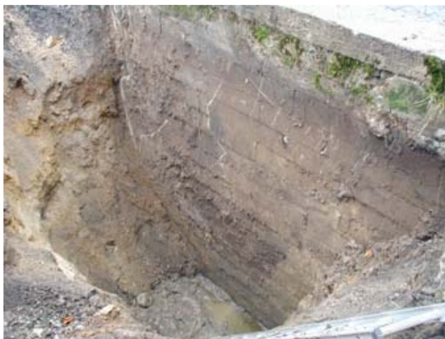
Figur 7.2 Ved beholdere uden kabler kan opgravningsstedet vælges frit. Her er gravet op ved en blokstensbeholdere.
