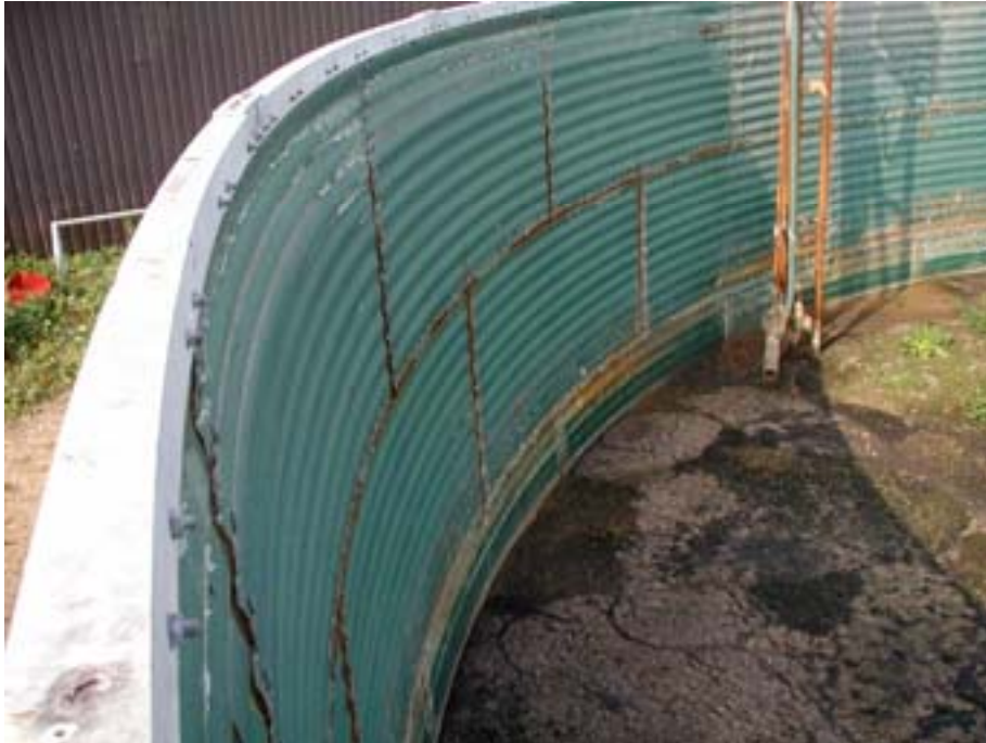
Figur 5.5 Stålbeholder med bølgeprofil. Det ses, at rusten angriber langs samlingerne mellem vægelementerne.
