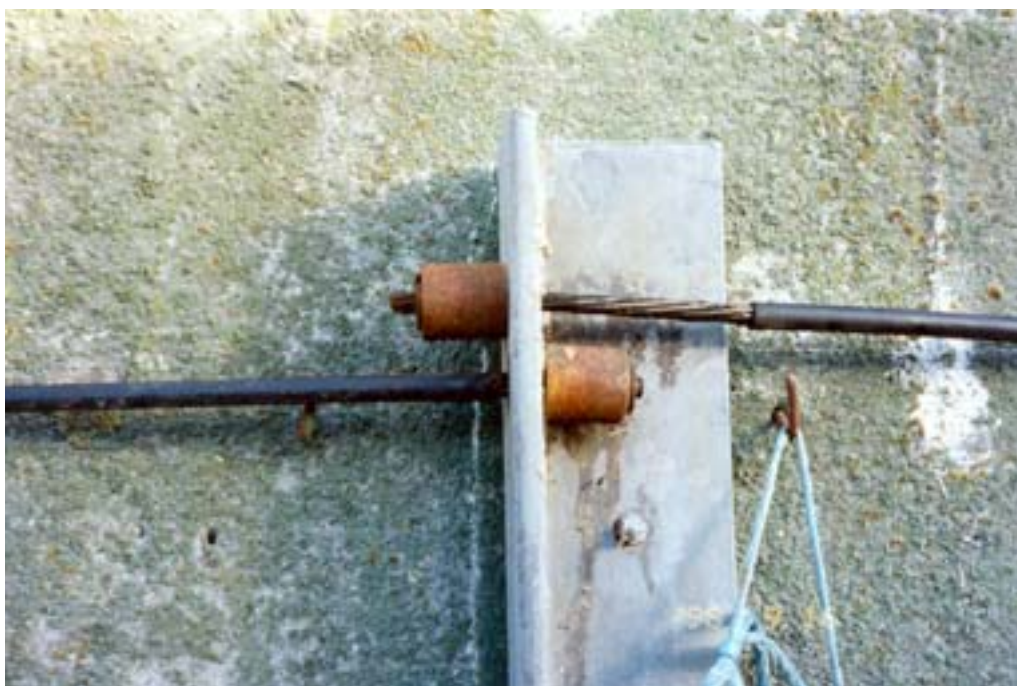
Figur 7.6 Kabelforankringen er let rusten og en del af kablet (til højre) er ikke beskyttet. Beskyttelse af såvel kabel som forankring samt påsætning af plasthætte vil normalt blive udført af kontrollanten.
