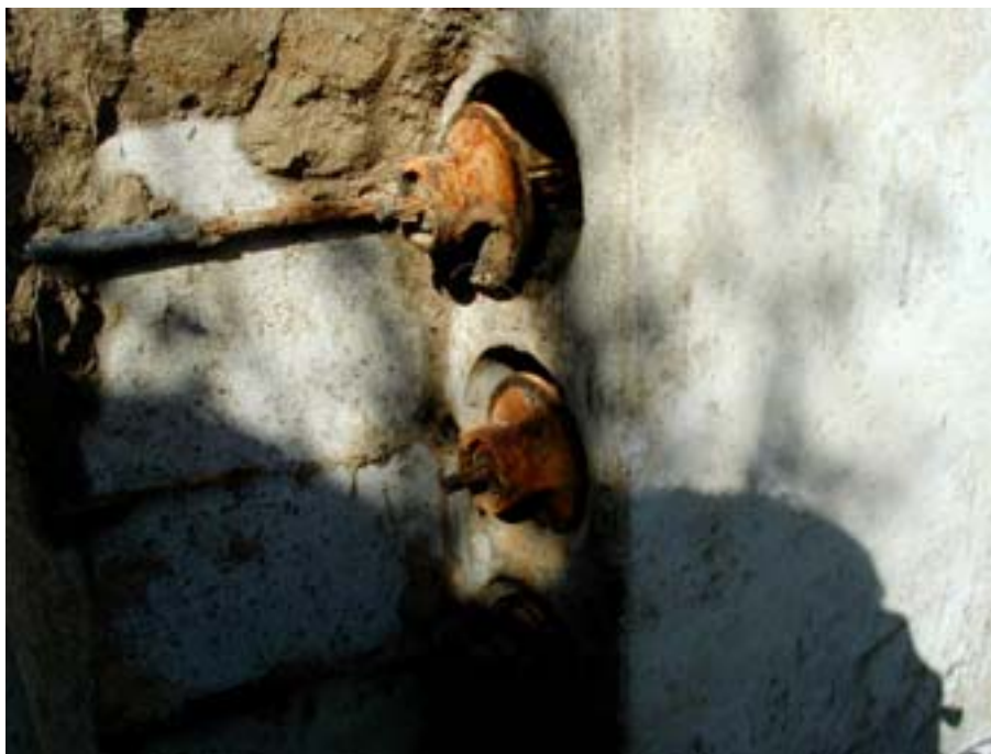
Figur 7.5 På sprungne kabler vil kabelforankringen normalt sidde løst som her.
