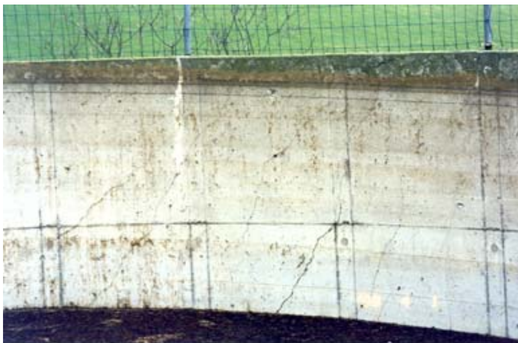
Figur 7.14 Her ses inderside af beholdervæg. Des ses kraftige revner (beholder er utæt) som følge af uens sætning af underbund. Beholderen er opført på kanten af en skråning.
