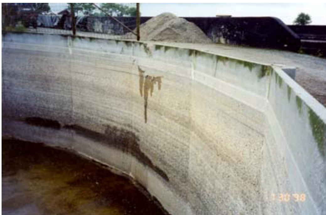
Figur 7.13 Denne beholder er på hele inderside skadet af sur væske som kan skyldes opblanding med ensilagesaft eller industriaffald. Der er også en skade som følge af påkørsel (vandindrængning ses).
