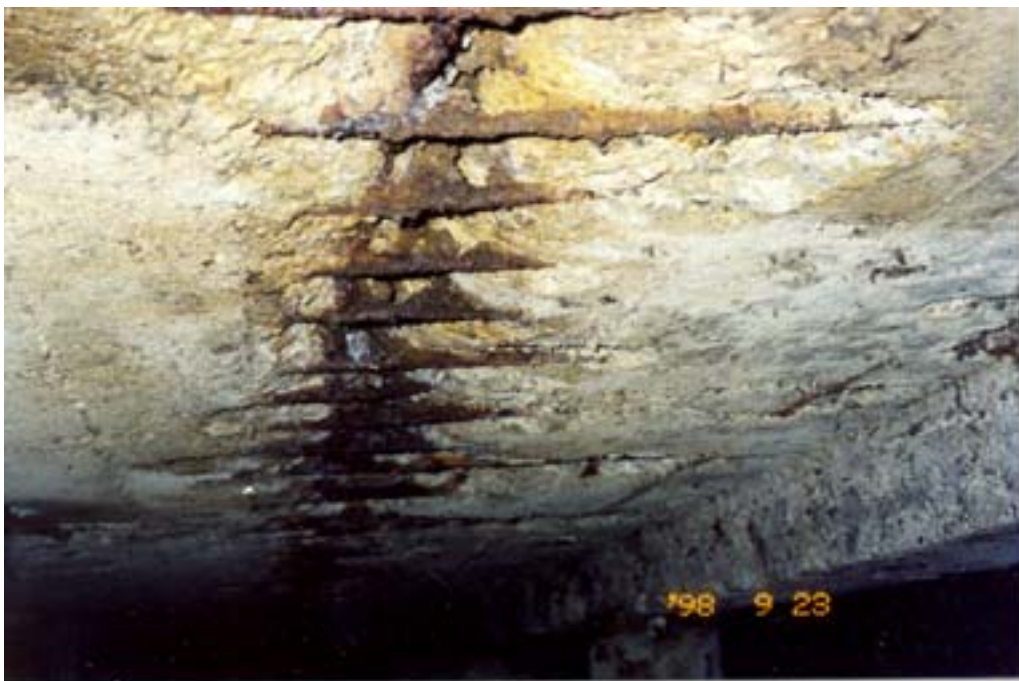
Figur 7.10 Undersiden af ældre betondæk kan være meget tærede af gyllen som det ses her. Færdsel på et sådant dæk er forbundet med fare for nedstyrtning.
