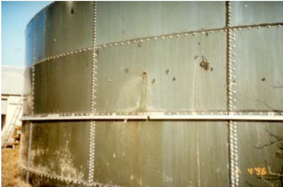
Figur 5.4 Stålbeholder med væg af flade profiler. Nogle stålbeholdere er som rustbeskyttelse glaserede, men hvis glasuren beskadiges, rustner stålet meget hurtigt.
