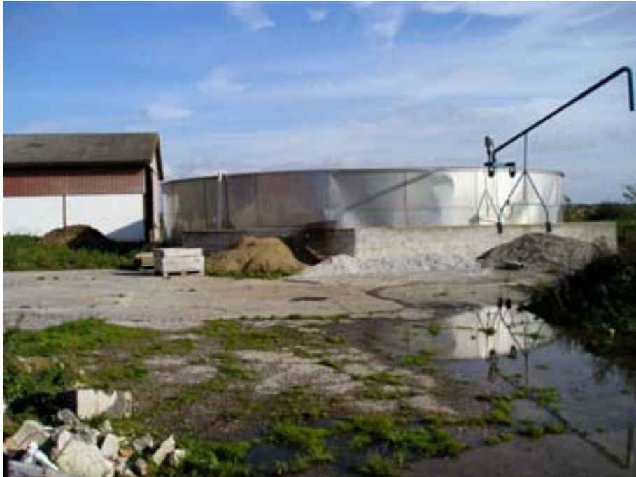
Figur 5.9 Dette er en beholder i rustfrit stål, delvis nedgravet. Der er ingen tegn på rustangreb. Der er meget få af denne type i danmark.
