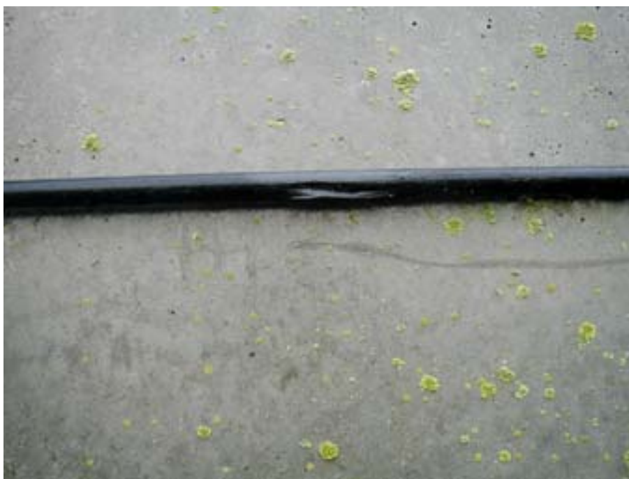
Figur 7.7 Kabler over terræn har ofte skader fra påkørsel eller andet. I de fleste tilfælde vil skaden blive udbedret af kontrollanten.
