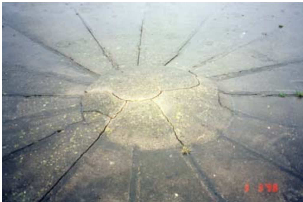
Figur 7.18 Dette er centret af et beholderlåg (set ovenfra). Revnerne antyder, at der har været bevægelser, antagelig som følge af opskudt bundplade.
