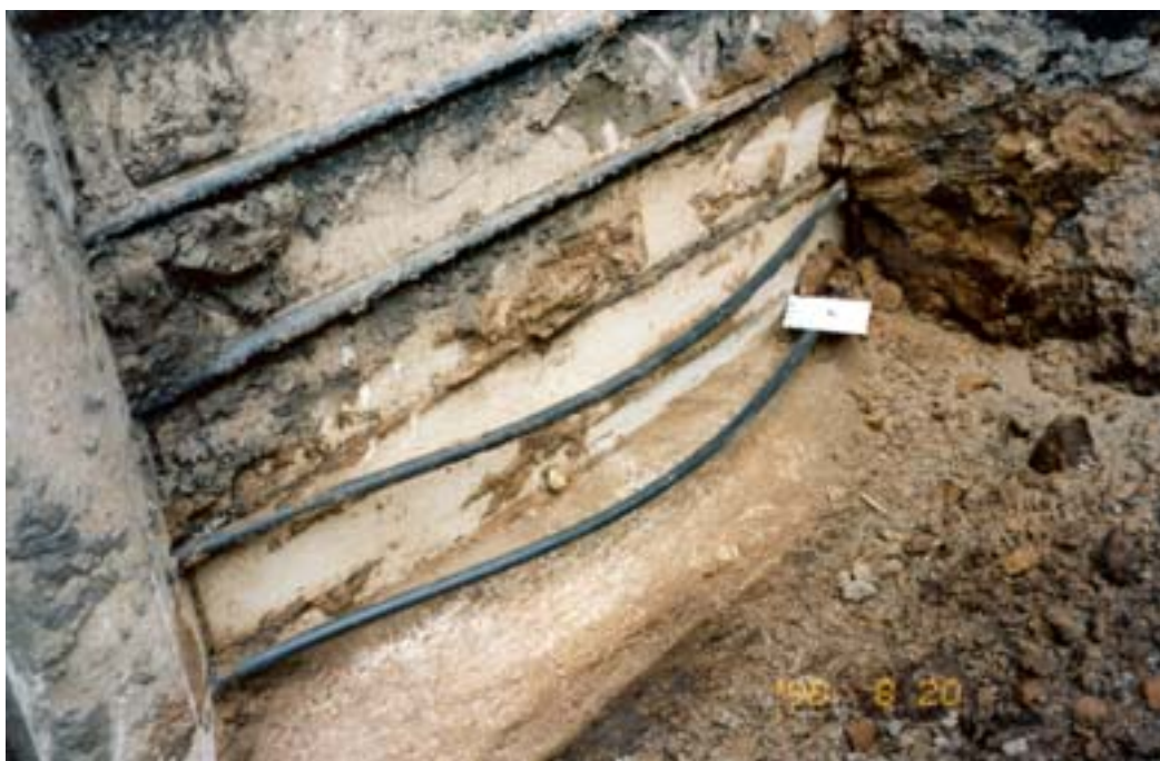
Figur 7.4 Ved denne beholder er de to nederste kabler sprunget. Der er aldrig problemer med at vurdere om et kabel er sprunget eller ej.
